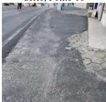
Figura 7 – Exemplo de reclamação referente aos pisos táteis, neste caso, a falta deles, Ponto 16
