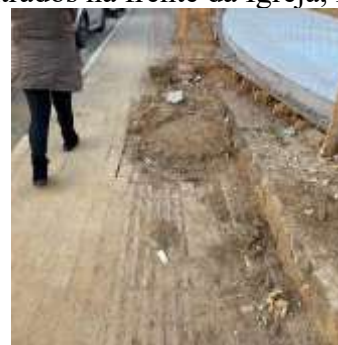
Figura 8 – Exemplo de problemas encontrados na frente da Igreja, Ponto 3
